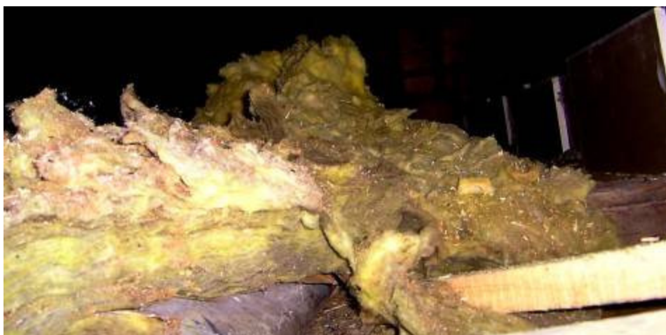
Schimmelfallene Mineralwollmatten in einem Dachgeschoß
